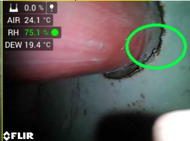
foto 28 0.03 sklep netěsnost prostupu
