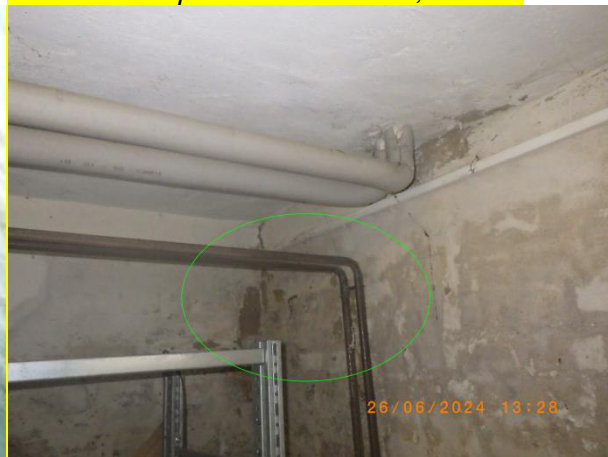
foto 22 0.02 prádelna koroze potrubí
