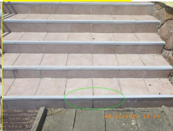
foto 50 poškozené/nevyplněné spáry obkladu
