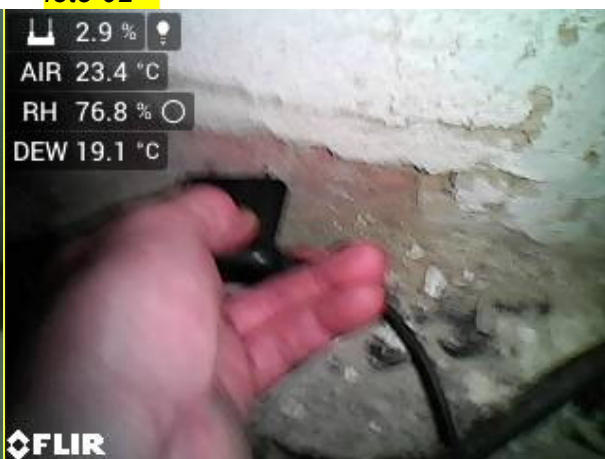
foto 04 0.01 schodiště vlhkost 2,9 % hm
