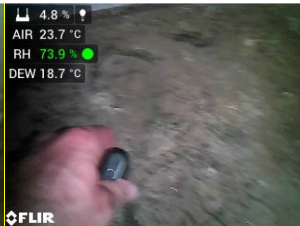
foto 30 0.03 sklep vlhkost podlaha 4,8 % hm
