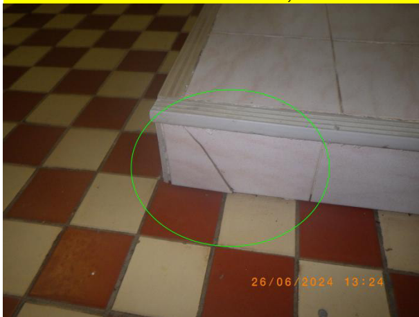
foto 13 0.02 prádelna poškozený obklad
