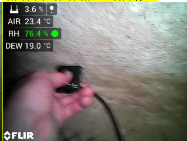
foto 08 0.01 schodiště vlhkost 3,6 % hm
