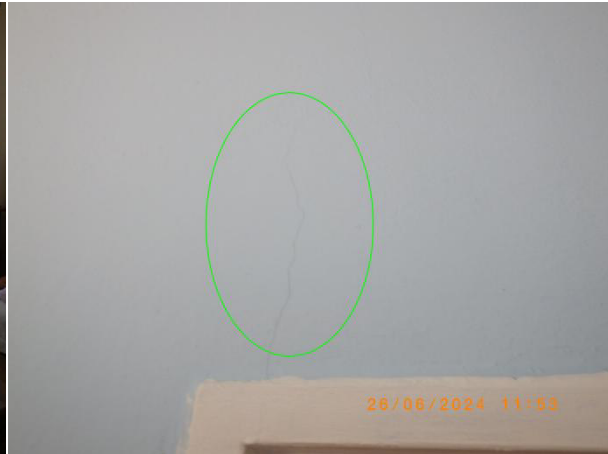
foto 58 1.05 obývací pokoj trhlina nad otvorem
