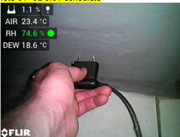
foto 03 0.01 schodiště vlhkost 1,1 % hm
