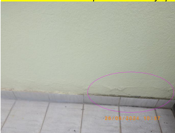
foto 73 2NP terasa poškození povrchu
