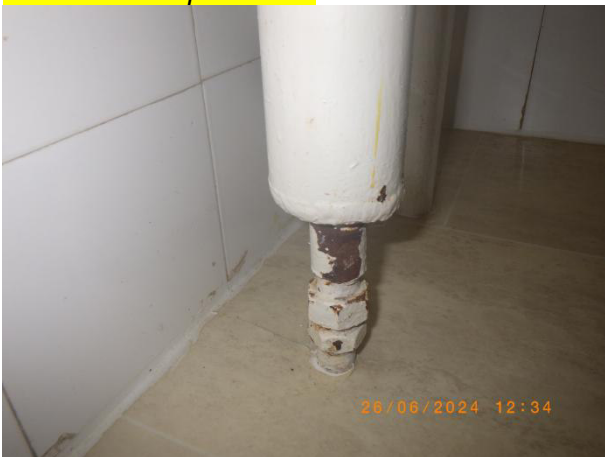
foto 67 1.09 WC koroze potrubí
