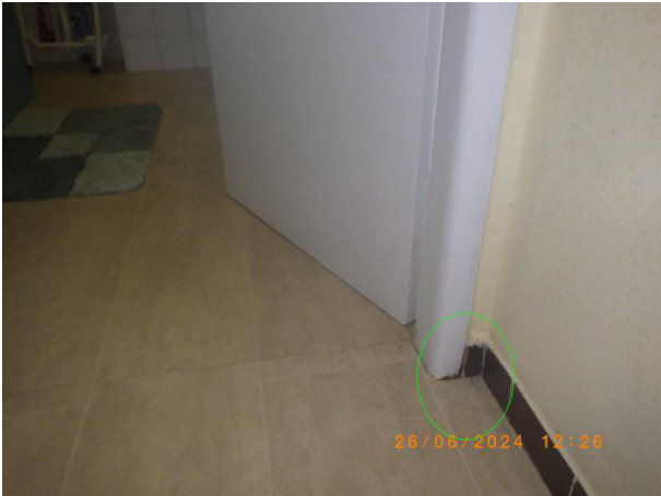
foto 63 1.07 chodba 2 poškození nátěru zárubně
