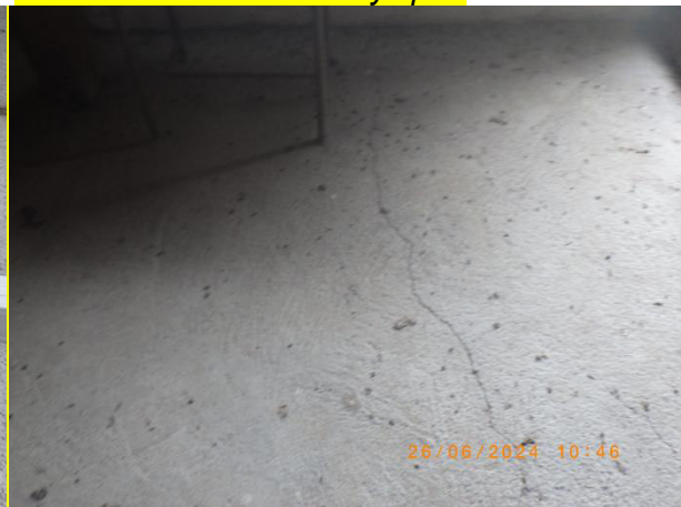
foto 76 půda od trhlin poškození podlaha
