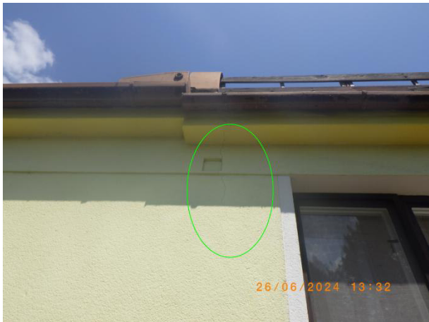
foto 91 trhlina římsa, fasáda
