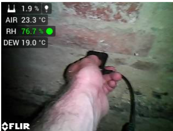
foto 05 0.01 schodiště vlhkost 1,9 % hm
