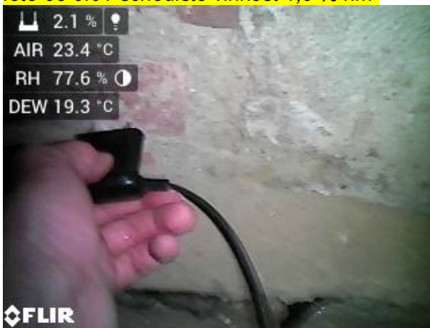
foto 07 0.01 schodiště vlhkost 2,1 % hm
