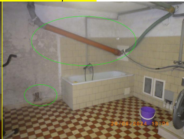
foto 14 0.02 prádelna koroze dvířek, odpadní potrubí
