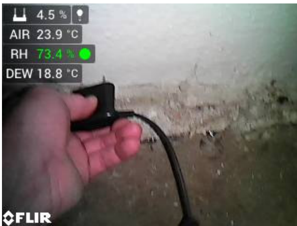
foto 29 0.03 sklep vlhkost 4,5 % hm
