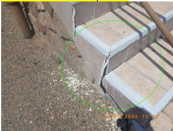
foto 49 0.06 poškozený obklad schodiště
