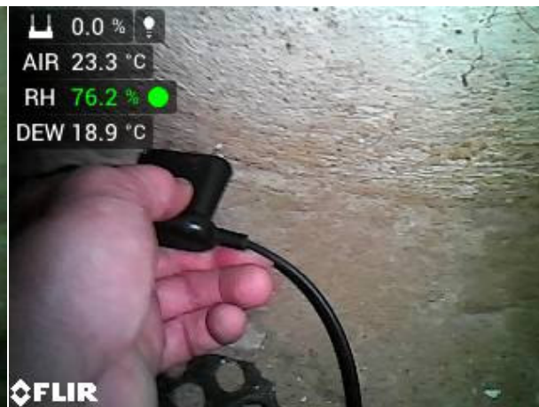
foto 06 0.01 schodiště vlhkost 0 % hm
