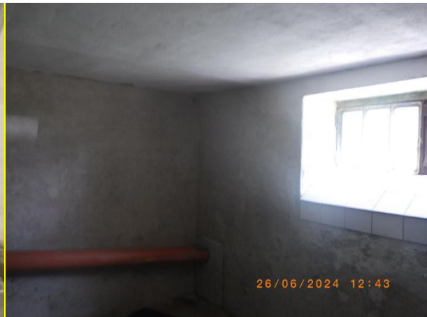
foto 24 0.03 sklep volně vedené potrubí kanalizace
