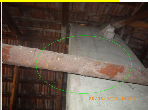
foto 82 poškození od dřevokazného hmyzu
