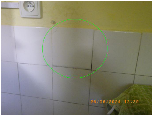
foto 69 1.10 koupelna poškozený obklad
