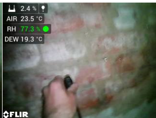
foto 10 0.01 schodiště vlhkost 2,4 % hm
