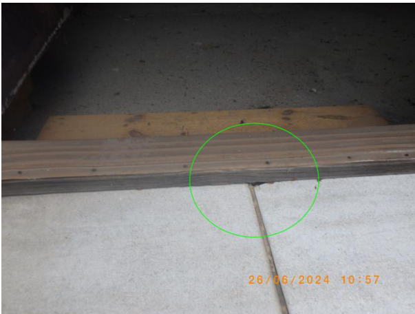
foto 70+ 71 2NP terasa poškození dlažby/spárování
