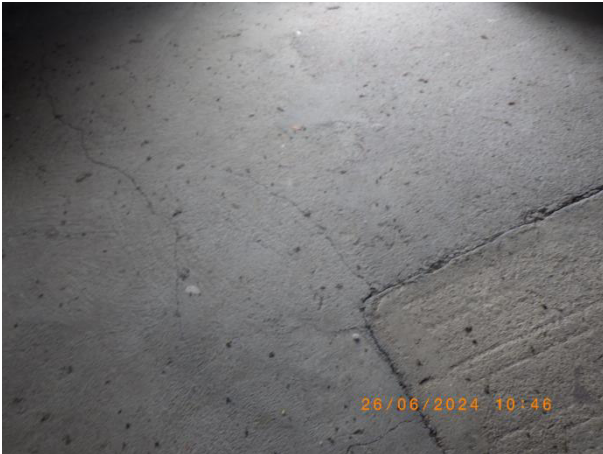
foto 77 půda od trhlin poškozená podlaha
