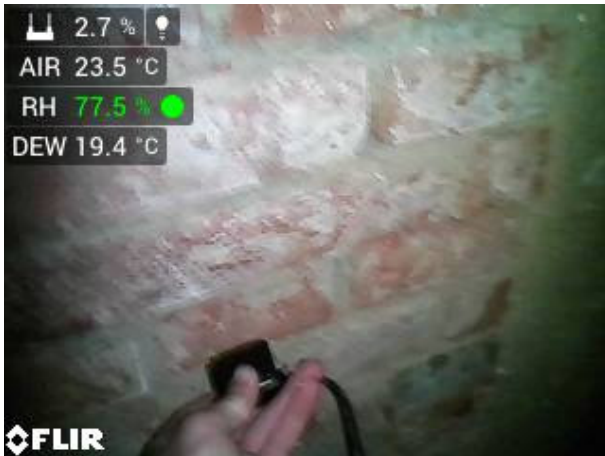
foto 11 0.01 schodiště vlhkost 2,7 % hm
