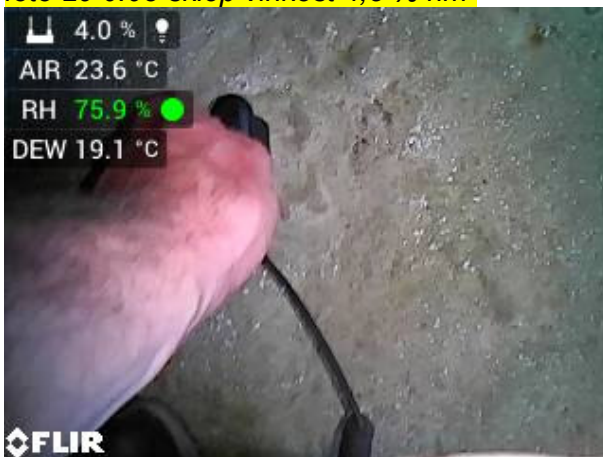
foto 31 0.03 sklep podlaha vlhkost 4 % hm
